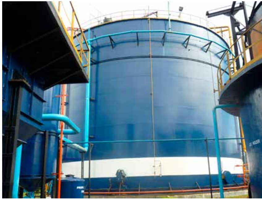
De bioreactortank van de palmoliefabriek van Perlabian
