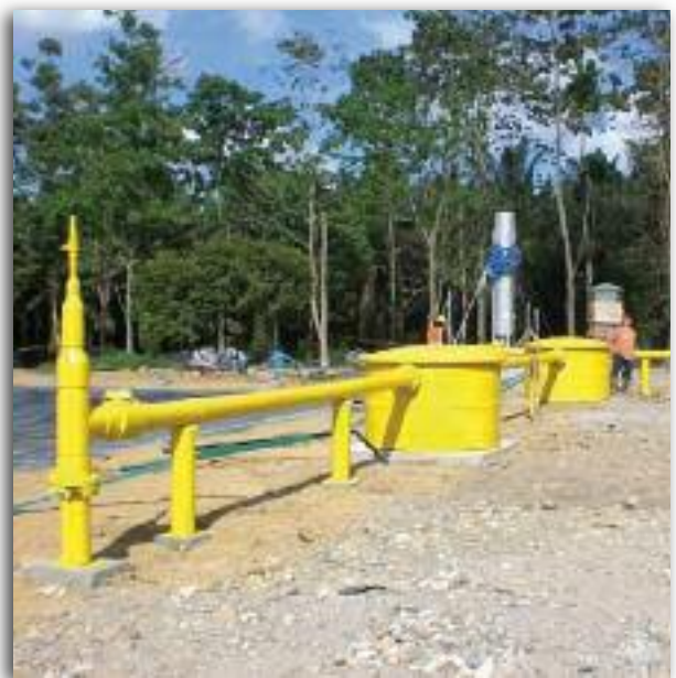
Installatie voor verbranding van methaangas
